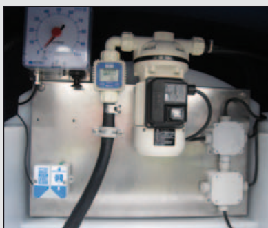
pohled do strojovny
